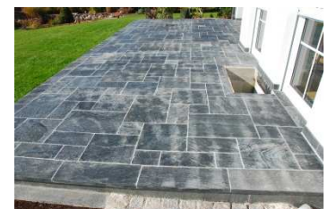
Abb.3, Flecken und Streifen durchziehen den Belag
